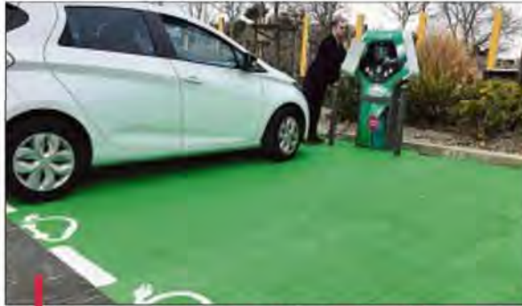
À Istres, 28 bornes doubles ont été installées pour permettre la recharge rapide des véhicules en ville.
